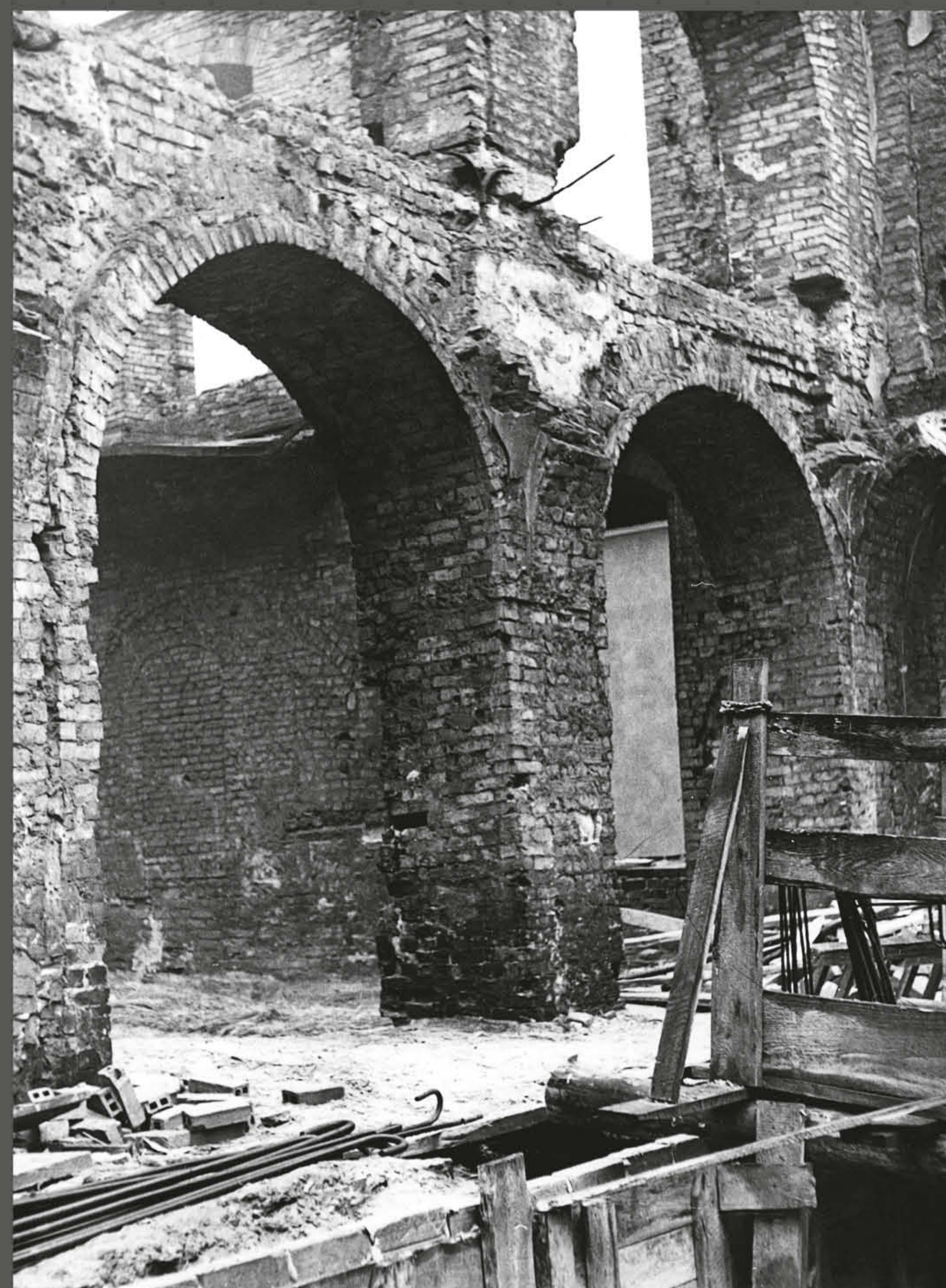
Odbudowa na wyższych kondygnacjach. Fot. C. Czub (1962 r.) Rebuilding works on upper floors. Photo: C. Czub (1962)
